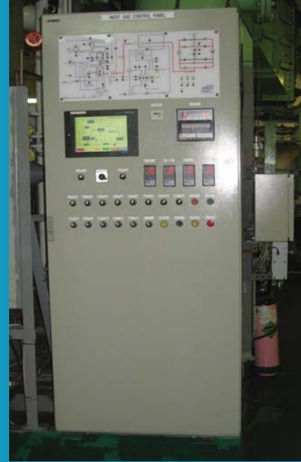
New Inert Gas System - LNG Edo
